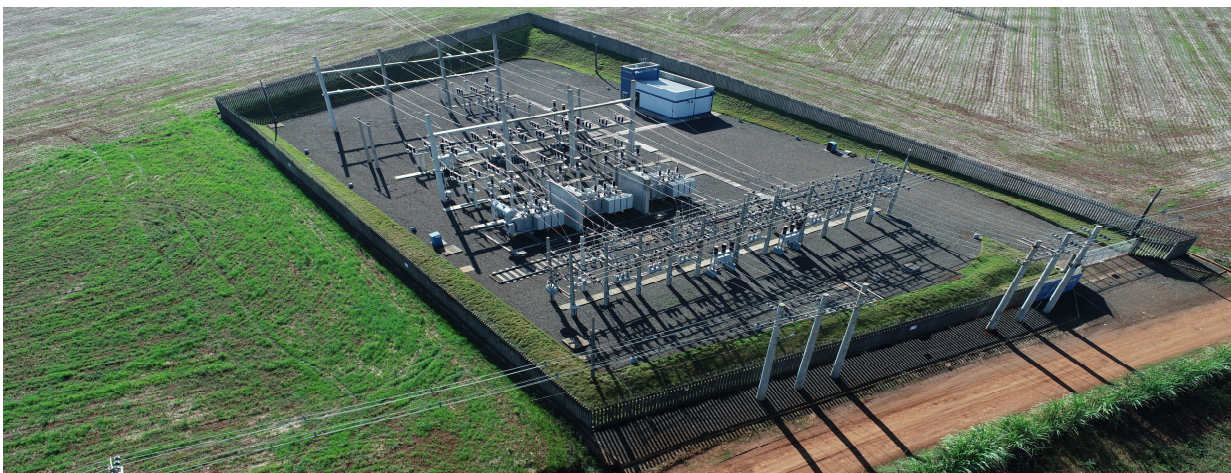
Foto: Subestação 69/23 kV – Potência Instalada 37,5 MVA - acervo Cooperluz
