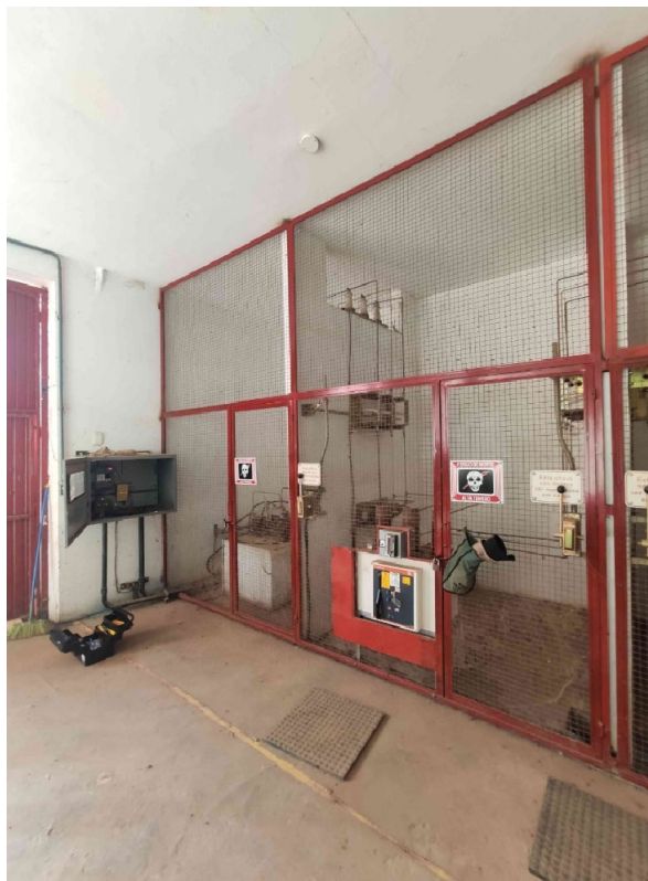
Cubículo de medição interna
